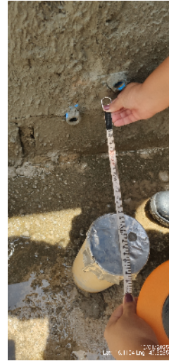
7-Ponto do vaso do banheiro 10/01/25 11:49:57
