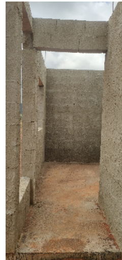
94-faltando ponto elétrico de arandela
