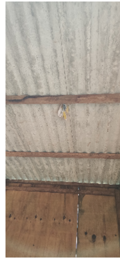
38-sanitário/vestiário 01 - sem instalações elétrica e aproveitamento das telhas 08/01/25 10:18:45
