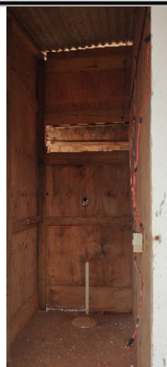
24-sanitário 02 sem acessórios e sem parte elétrica 08/01/25 10:08:51
