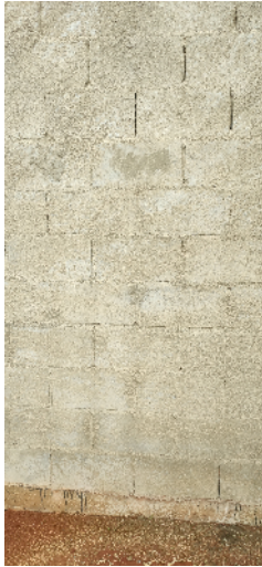
133-chapisco com má execução 08/01/25 14:14:39
