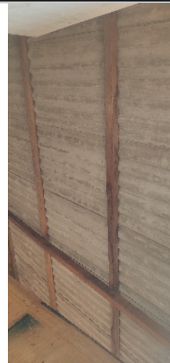
40-sanitário/vestiário 02 - sem instalações elétrica e aproveitamento das telhas 08/01/25 10:20:28
