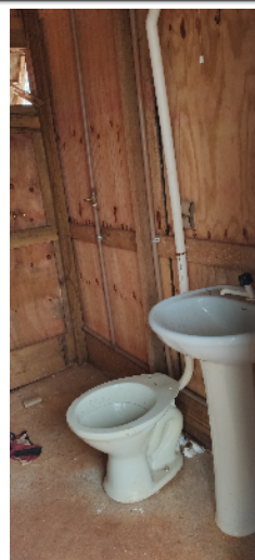
22-acessórios do sanitário 1 sem aproveitamento 08/01/25 10:05:56
