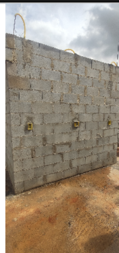
7-visão geral das instalações elétricas da sala casa 12 da quadra 14 08/01/25 15:00:19
