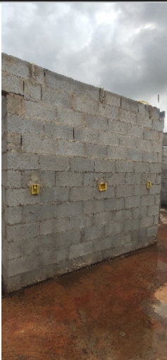
18-visão geral da parte elétrica da sala casa 13 da quadra 14 08/01/25 15:05:27
