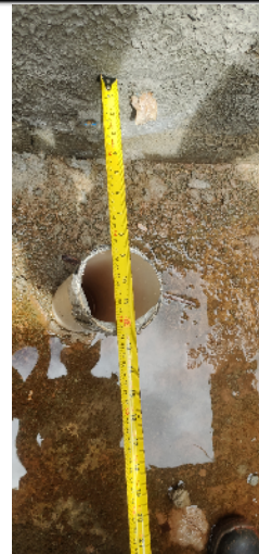
140-ponto de esgoto da bacia sanitária muito próximo da parede e terá que fazer a correção.
