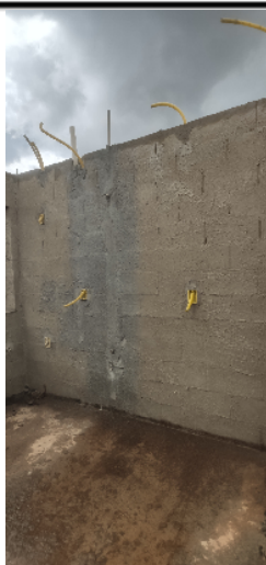
123-visão geral das caixas elétrica da cozinha e ponto de água e energia da cozinha
