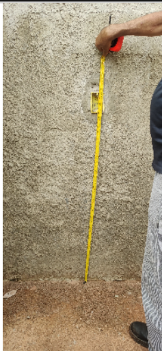
91-visão geral da caixa elétrica da cozinha
