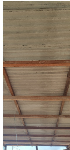
14-refeitório sem instalações elétrica 08/01/25 09:52:46
