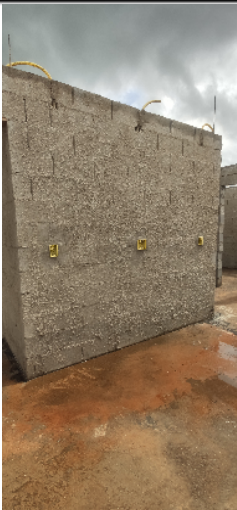
135-visão geral das caixas elétricas 4x2 da sala casa 11 da quadra 14 08/01/25 14:15:37
