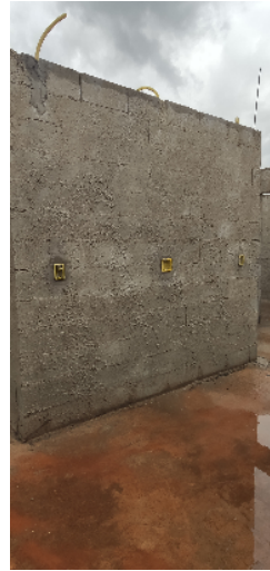
110-caixas elétrica 4x2 da casa 09 da quadra 14 08/01/25 13:55:14
