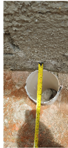
82-ponto de esgoto da caixa sifonada do box do banheiro
