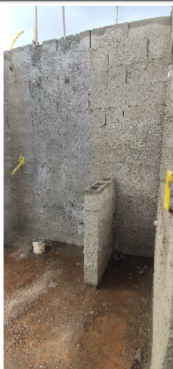
125-visão geral do ponto de água e esgoto do tanque e da máquina de lavar e caixas elétricas.
