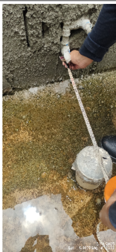
142-Ponto do vaso sanitário - casa 56 - Qd 14 10/01/25 12:47:45
