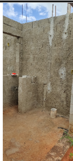
48-área de serviço - sem aproveitamento das instalações (registros...)
