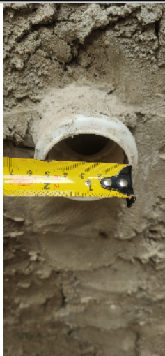
75-diâmetro do tubo de esgoto com divergência do projeto casa 08 da quadra 14 08/01/25 11:35:35
