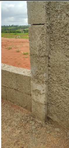
95-várias falhas de chapisco
