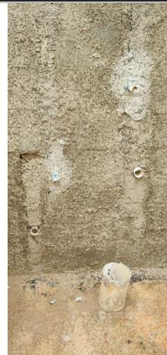
56-tubo do tanque sem anel de vedação e não está na altura adequada do piso acabado 08/01/25 11:13:24
