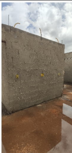
121-visão geral das caixas elétricas 4x2 da sala
